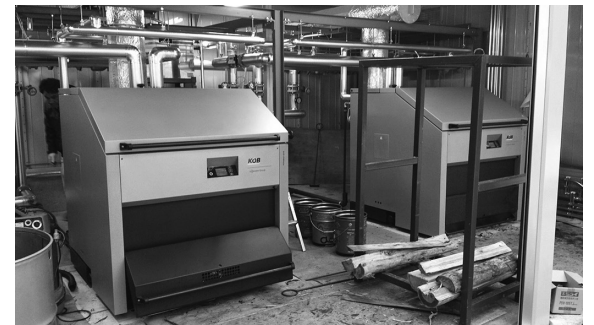
写真 3 KOB 社製 薪ボイラー (黄金泉)
