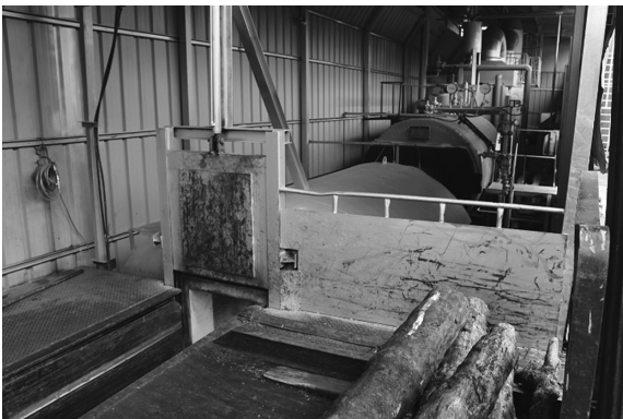
写真2 丸太ボイラー
