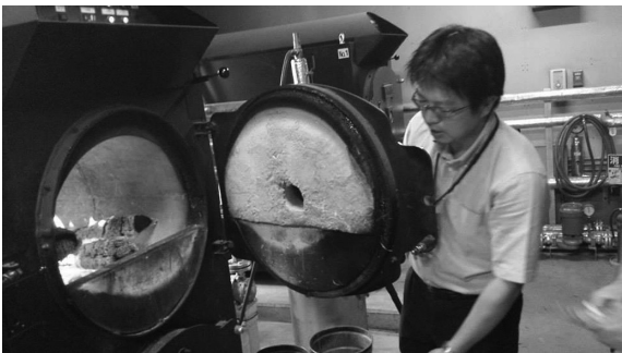
写真1 薪ボイラー（土佐和紙工芸村）
